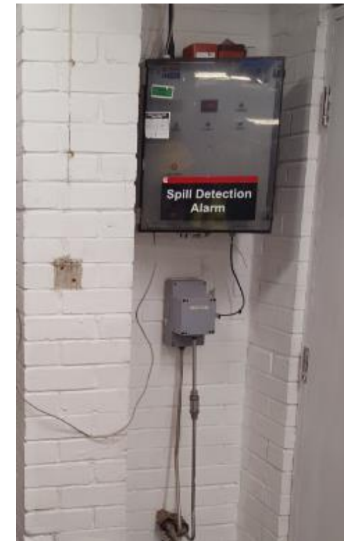
Una imagen de la unidad instalada en la planta de fabricación.
