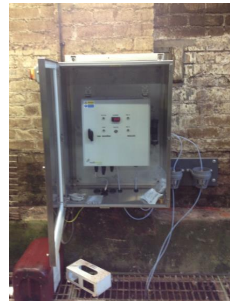
Unidad instalada en una planta de aguas residuales en Escocia para detectar altos niveles de COV
