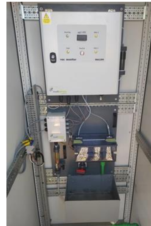
Una imagen de la unidad instalada en la cabina.
